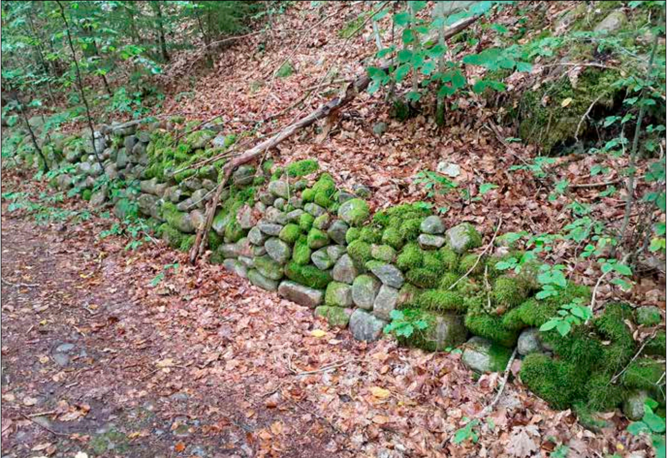
Figur 16. Terrasseringen L2023:4710. Bilden är tagen från vägen mot slutningen. Foto mot nordväst.
