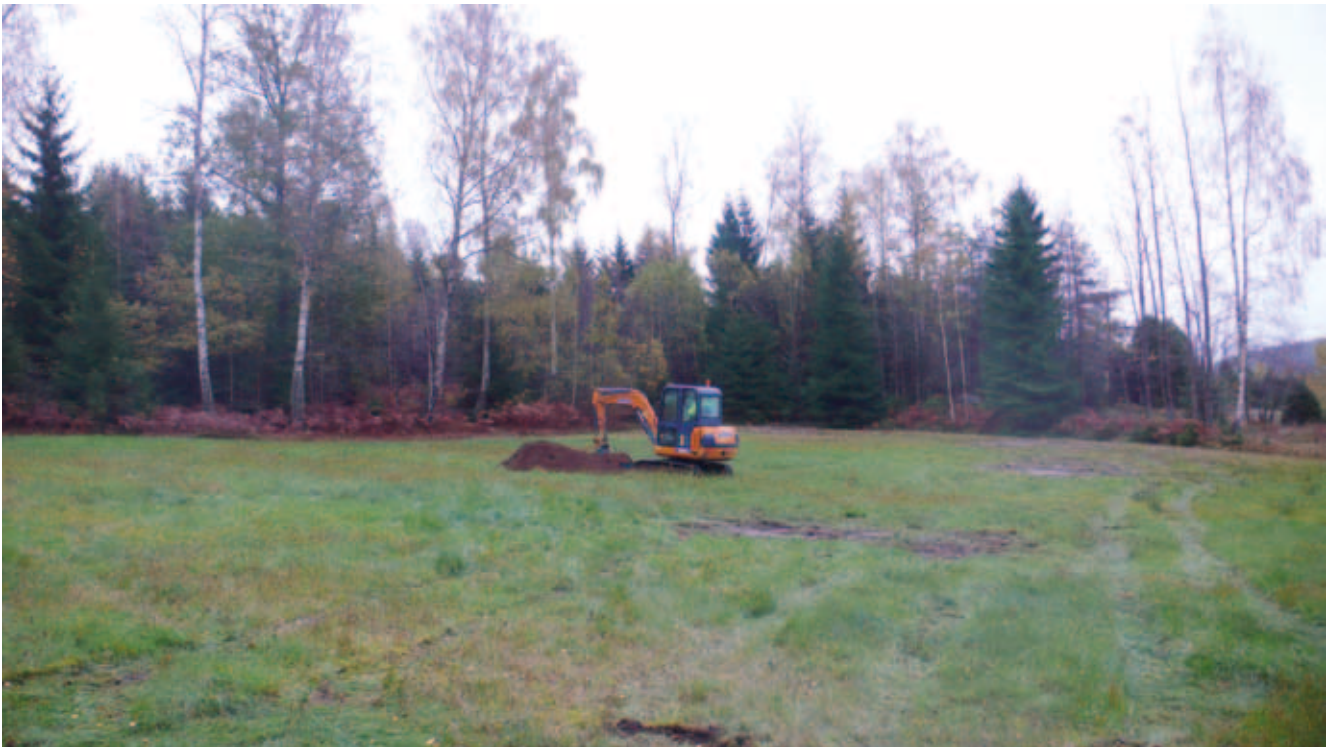
Illustration 4. Dag två inleddes med ett sista schakt vid Högås 139, schakt 8. De igenlagda schakt 1 till 4 ans höger om och bortom maskinen. Foto mot öster.
